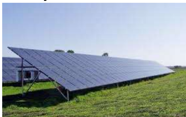
Impianto FV a terra
